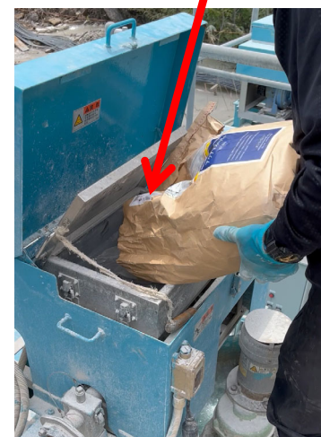
ヒ素除去用 凝集剤投入写真
